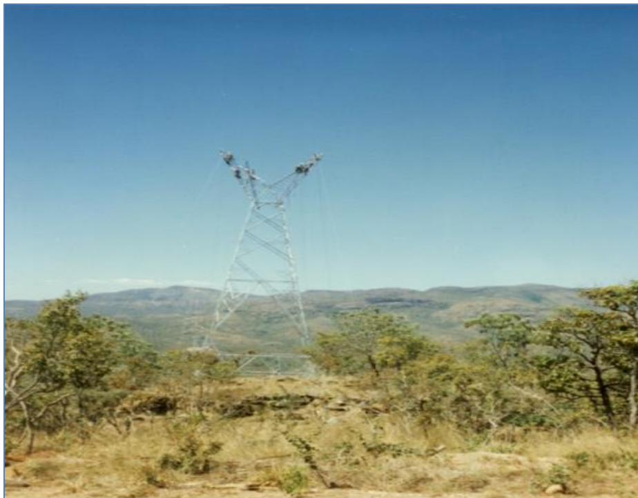
Figura 29: Linhas de transmissão de energia elétrica dentro da Terra Indígena Avá-Canoeiro
