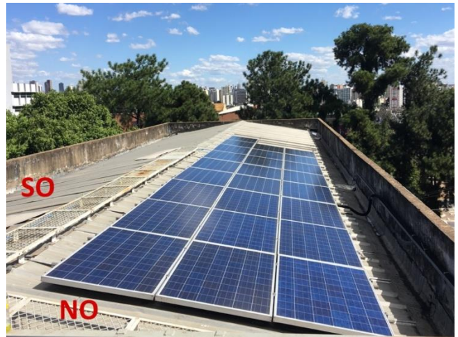
Fig. 18. Sistema Fotovoltaico EMC/UFG – Lado Oeste. [14]
