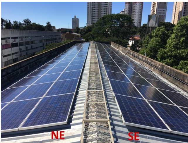
Fig. 17. Sistema Fotovoltaico EMC/UFG – Lado Leste. [14]
