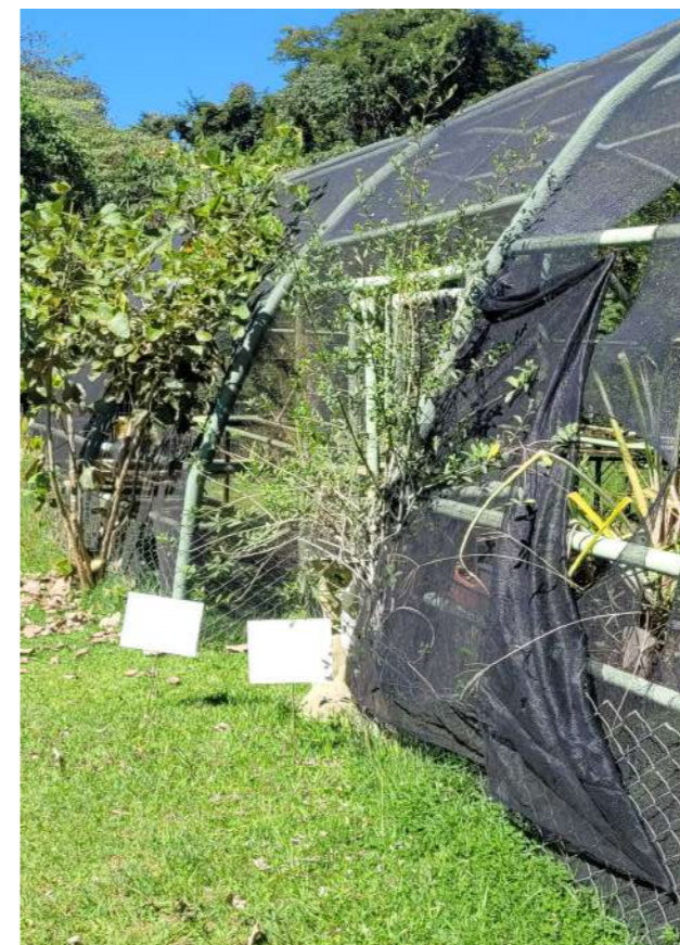
Figura 04: A estrutura que seria o Borboletário está rasgada e abandonada. Acervo pessoal.
