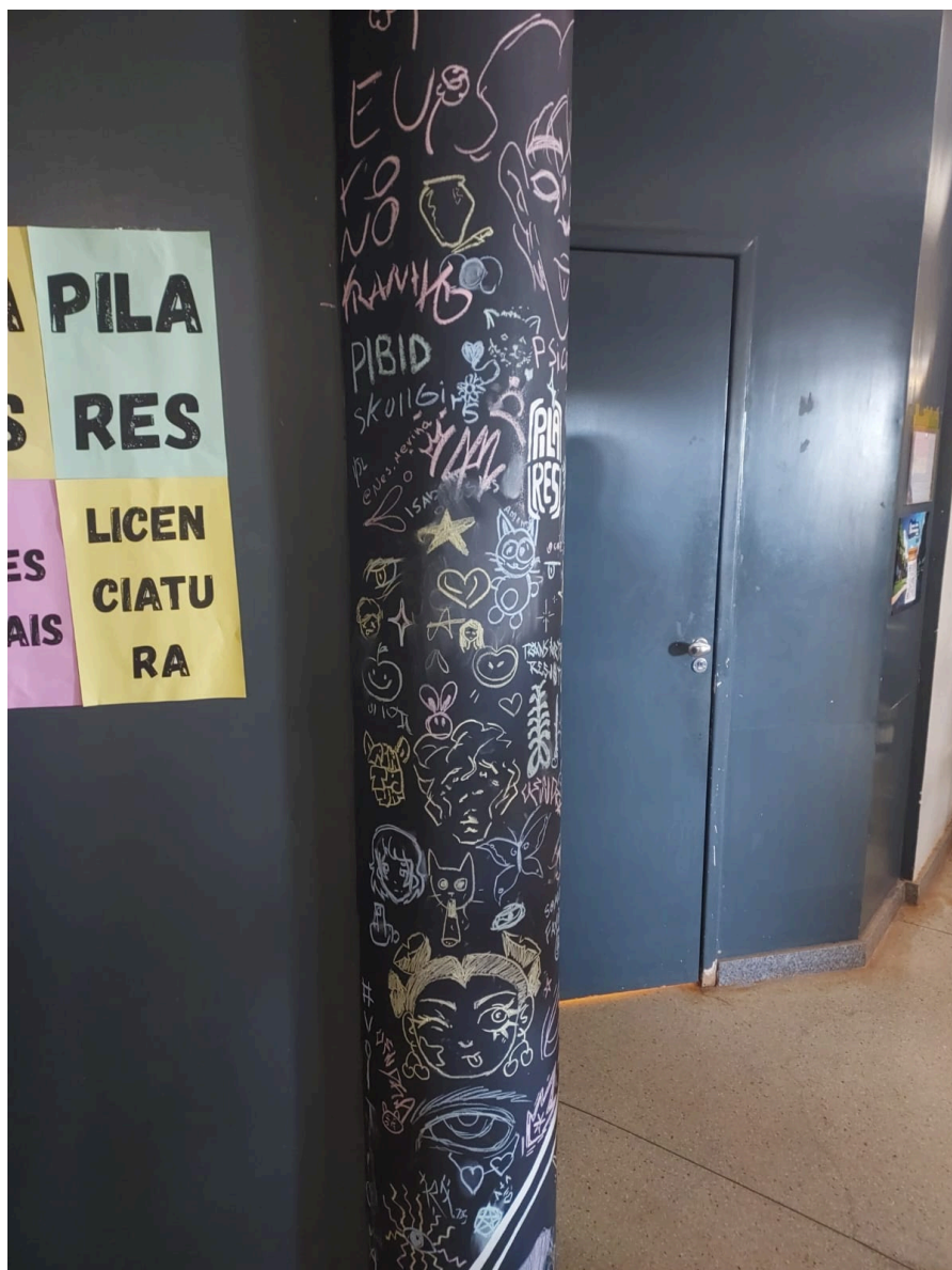
Figura 2 – Pilar de giz primeiro dia, andar térreo da FAV-UFG
