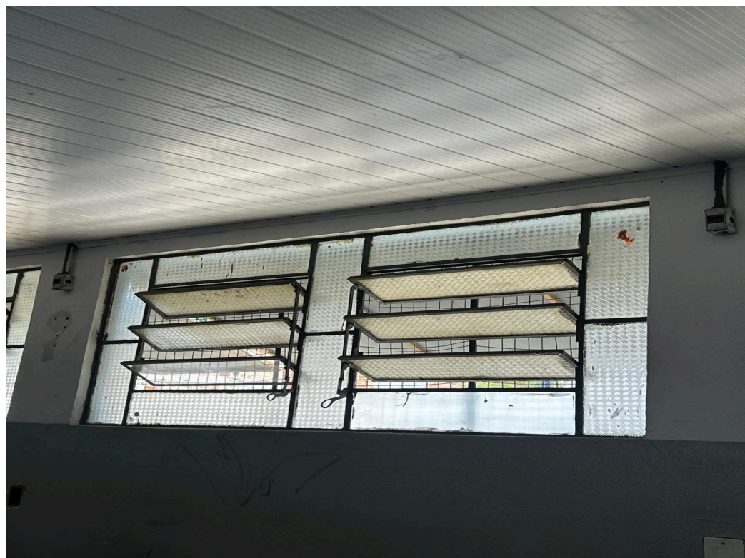
Imagem 1 — Janela da escola com grades.
