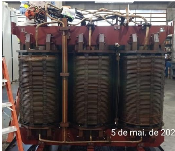
Figura 11 – Parte ativa do transformador de potência, visão frontal
