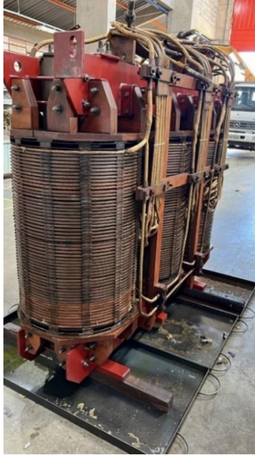
Figura 12 – Parte ativa do transformador de potência, visão lateral
