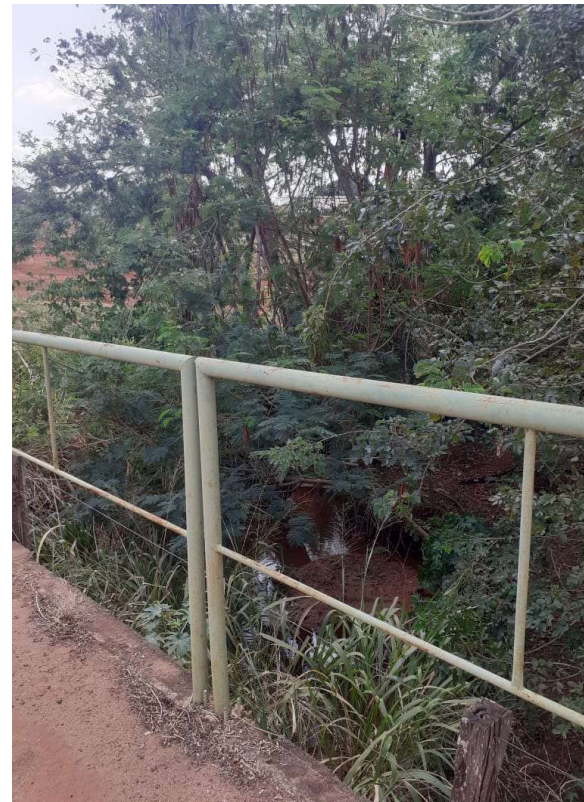
Figura 42: Condição semelhante à uma ponte em passeio pela rua Filogônio de Sá.
