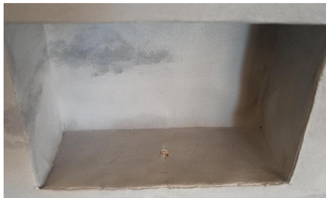
Figura 118 – Orifício feito diretamente na tela e em sua estrutura. 2023. Fonte: Acervo do autor.
