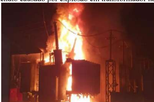
Figura 3 - Incêndio causado por explosão em transformador na SE de Macapá
