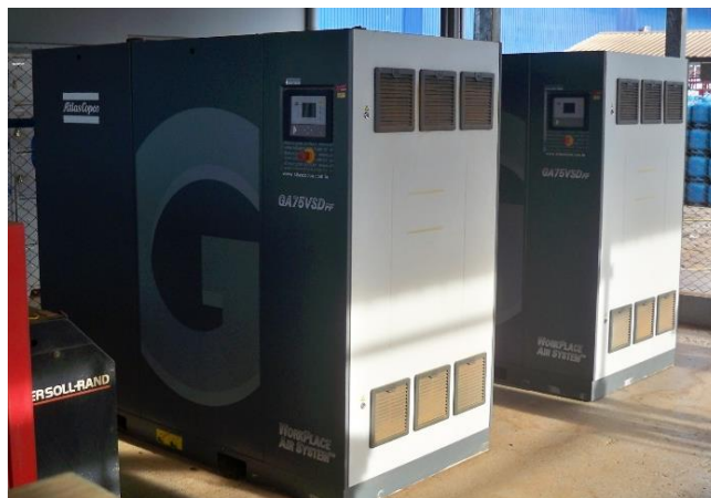
Figura 27 - Compressores Atlas Copco instalados no local de estudo.
