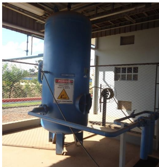
Figura 37 - Reservatório de ar comprimido instalado no local de estudo.
