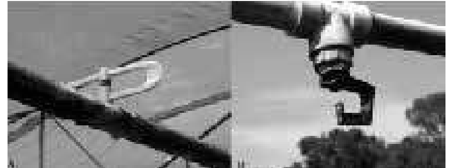
Imagem 24: Micro aspersores instalados
