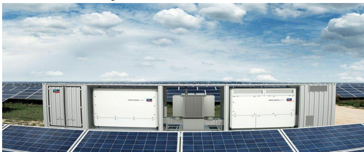
Figura 2.1. Inversores e módulos fotovoltaicos
