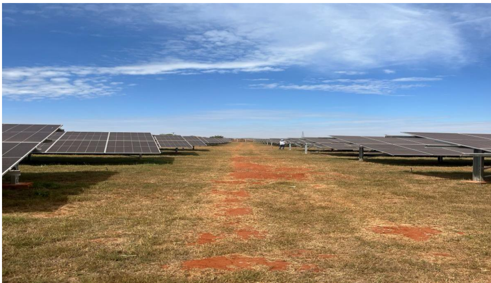
Figura 4.1. Usina Fotovoltaica SOLARPOWER.
