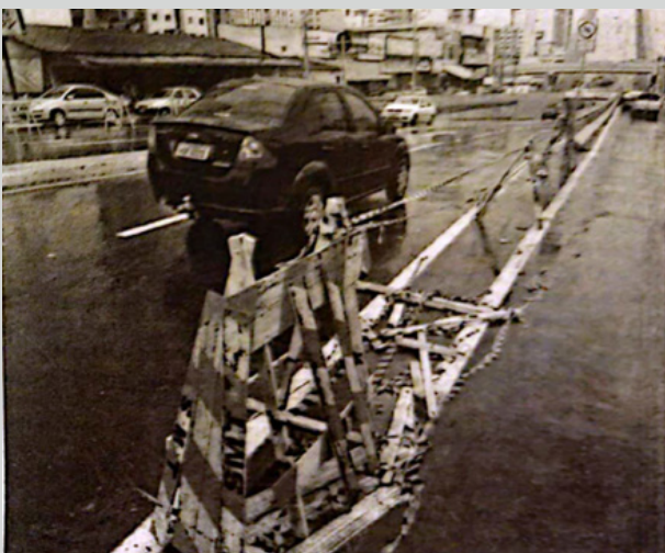
Figura 34: Cavalete que impedia a conversão da T-64 à S-1, destruído.
