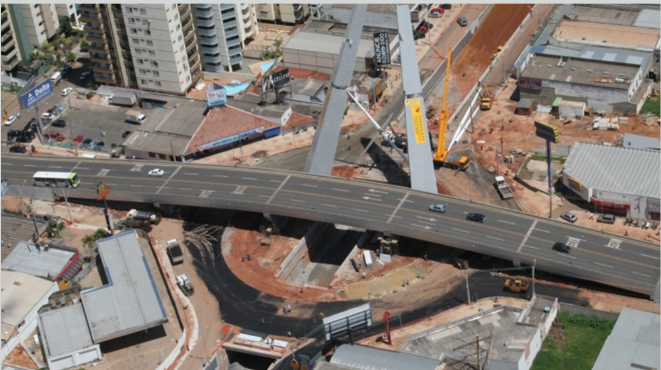
Figura 31: Viaduto da T-63 em funcionamento enquanto as obras da praça e da trincheira ainda eram finalizadas.
