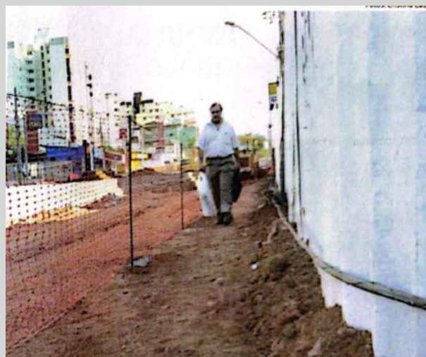
Figura 33: Pedestre fazendo o percurso de 25 minutos para travessia da avenida, via passarela improvisada.
