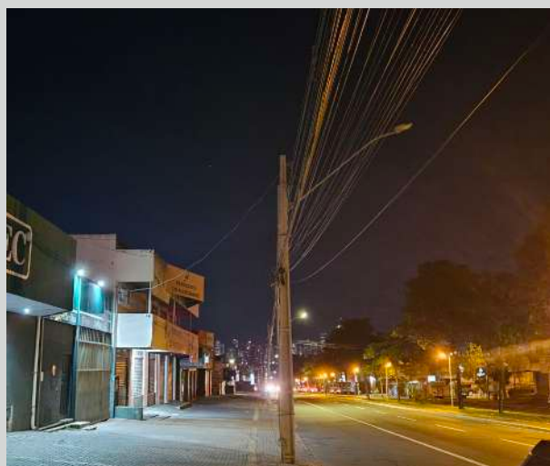
Figura 61: Iluminação recentemente trocada já não funcionando. Fonte: do autor, 2025.
