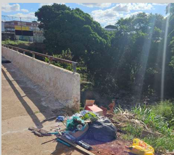
Figura 65: Lixo descartado inadequadamente na passagem acima da ponte do Cór. Cascavel.
