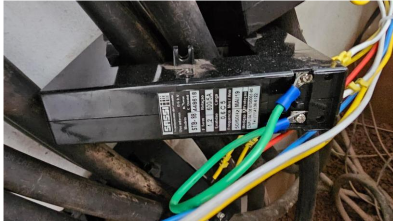
Figura 16: Foto do transformador de corrente instalado no painel
