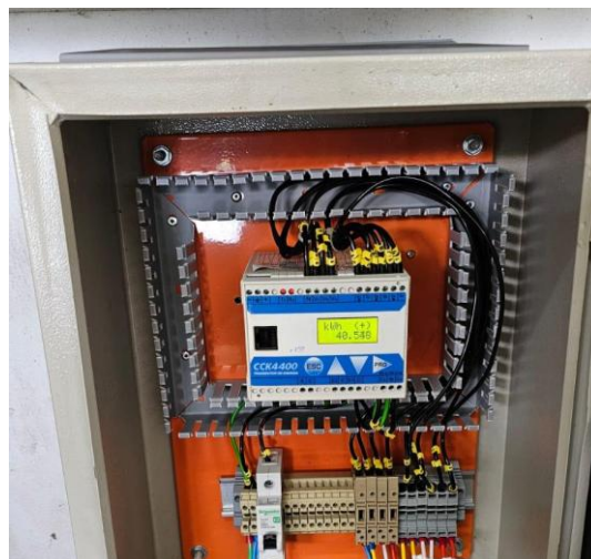
Figura 17: Foto do medidor de entrada do Quadro
