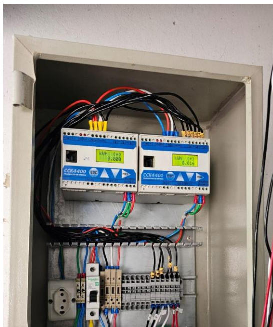
Figura 18: Foto dos medidores instalados nos circuitos da Ala A e Ala B
