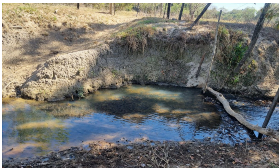
Figura 28: Depósito arenoso claro e pouco coeso junto à drenagem, formado por sedimentos fluviais recentes.
