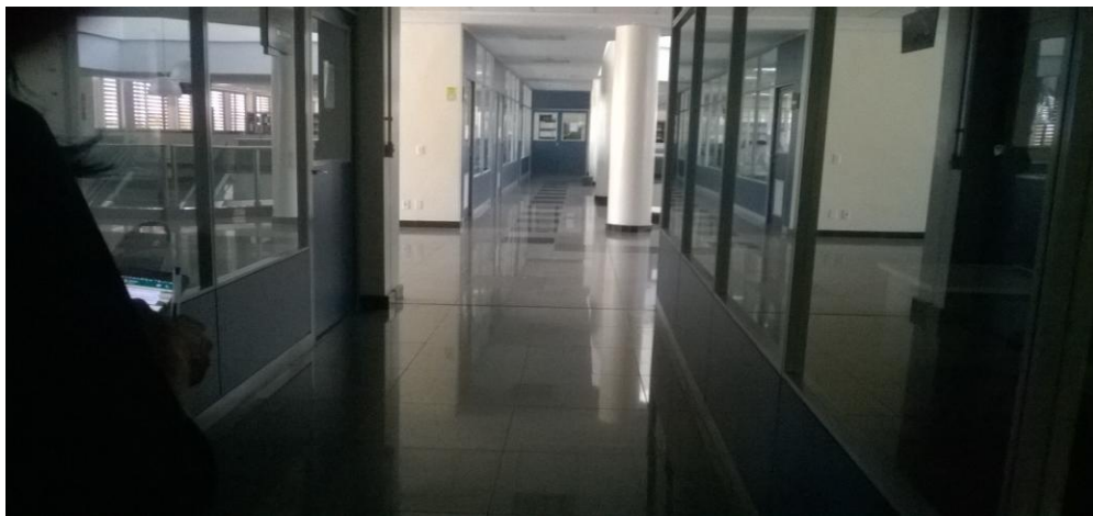
Figura 3: Piso inadequado à pessoa com deficiência visual
