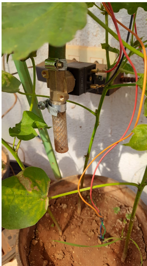
Figura 3.17: Válvula instalada para irrigação.
