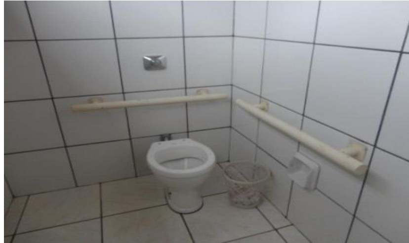
Figura 14: Válvula de descarga de fácil acionamento – Escola C
