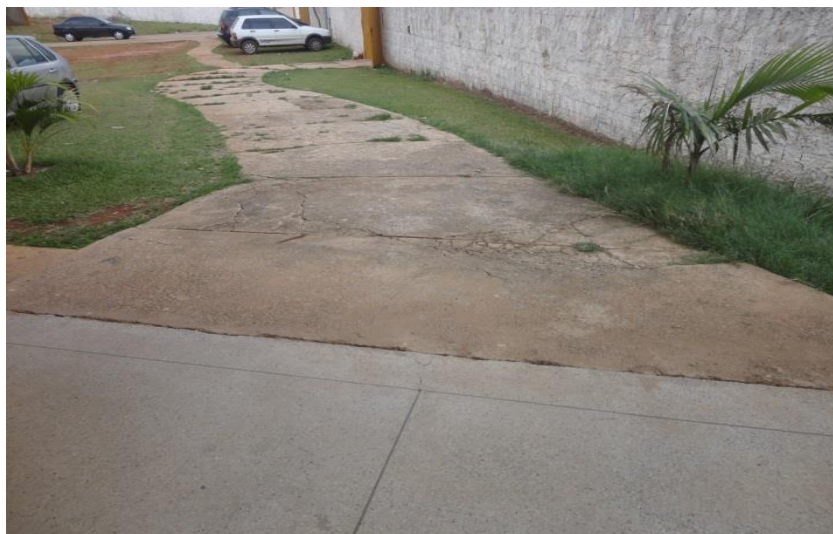
Figura 19: Rampa com acessibilidade comprometida – Escola H
