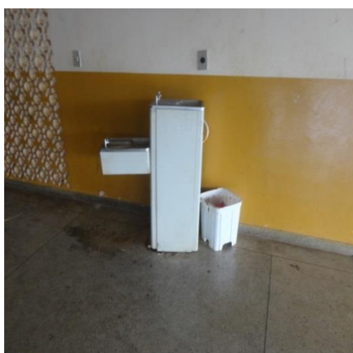
Figura 6: Bebedouros não adaptados – Escola C
