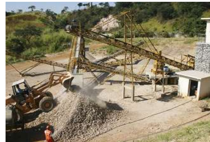
Imagem 06 | Estação de reciclagem de RCD em Belo Horizonte Fonte: prefeitura.pbh.gov.br
