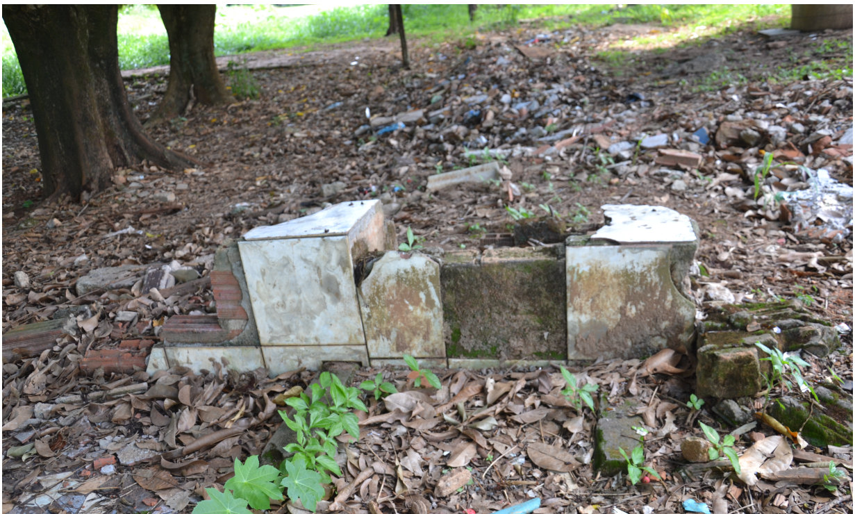
Figura 12. Evidências de remoções, às margens do Córrego Pedreira, Jardim Guanabara II
