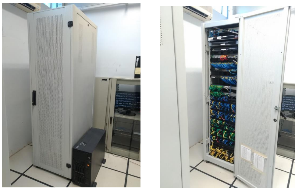
Figura 28 - Rack Centralizador com a porta fechada e aberta
