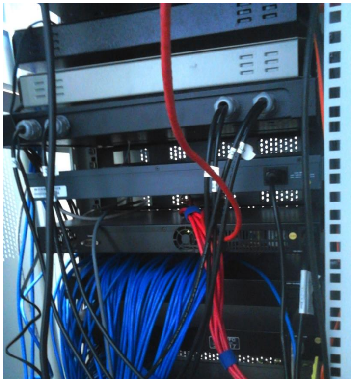
Figura 40 - Parte traseira do rack após a reorganização dos equipamentos e cabeamento Fonte: Os Autores
