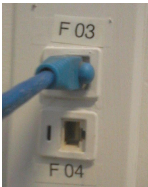
Figura 41 - Identificação de tomadas de telecomunicação Fonte: Os Autores
