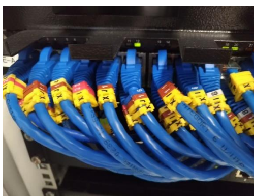
Figura 29 - Identificação dos patch cords
