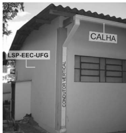
Figura 7 - Calha de captação de água de chuva LSP-EEC-UFG
