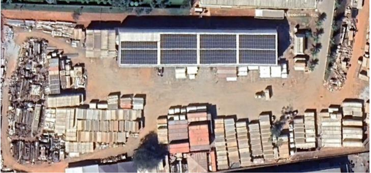
Figura 13 - Visão aérea dos módulos fotovoltaicos instalados na empresa Cesar contêiners
