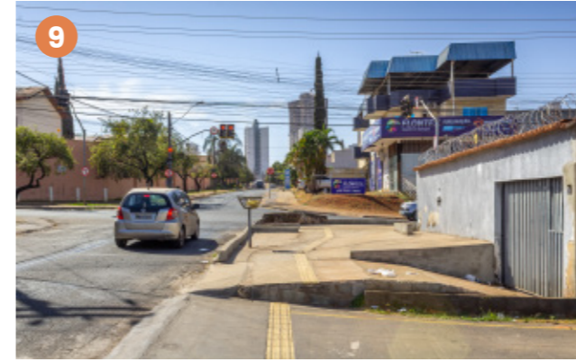
Figura 83: Desnívelamento de calçada Fonte: Heitor Rocha, 2024
