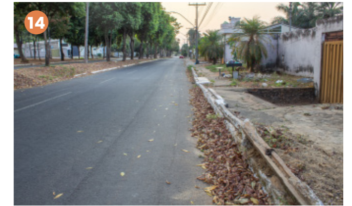
Figura 88: Desnívelamento de calçada Fonte: Heitor Rocha, 2024
