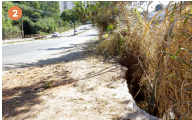
Figura 76: Erosão na calçada Fonte: Heitor Rocha, 2024
