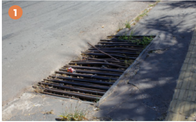
Figura 75: Infraestrutura de drenagem na calçada Fonte: Heitor Rocha, 2024
