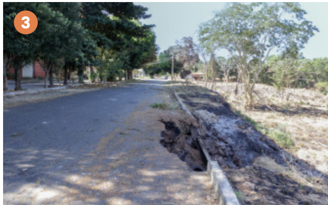
Figura 77: Ausência de calçada e erosão na rua Fonte: Heitor Rocha, 2024
