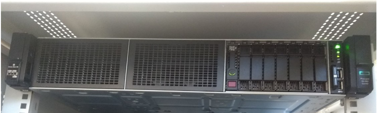
Figura 15 – Servidor de Aplicação e unidades de armazenamento instalados na EMC.
