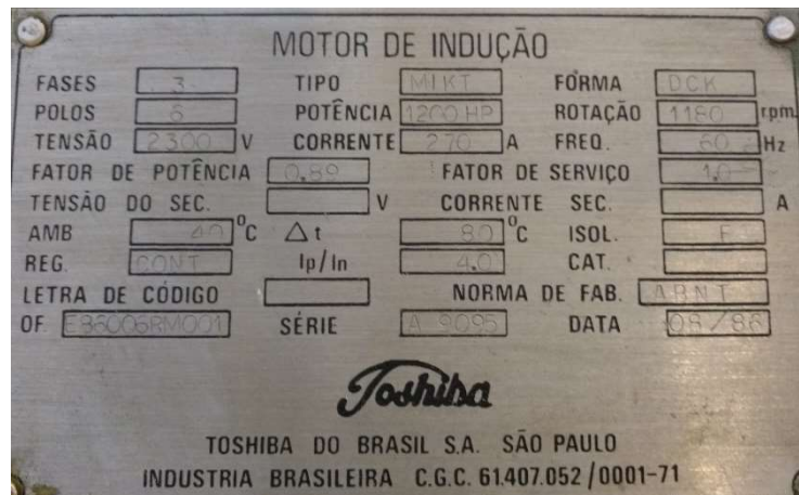
Figura 18 - Dados de placa motor de indução trifásico 1200 HP
