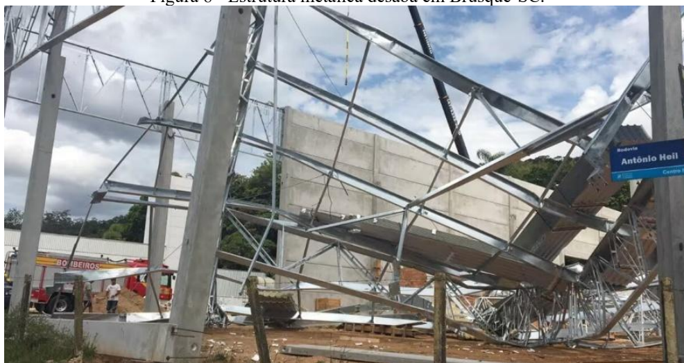
Figura 8 - Estrutura metálica desaba em Brusque-SC.
