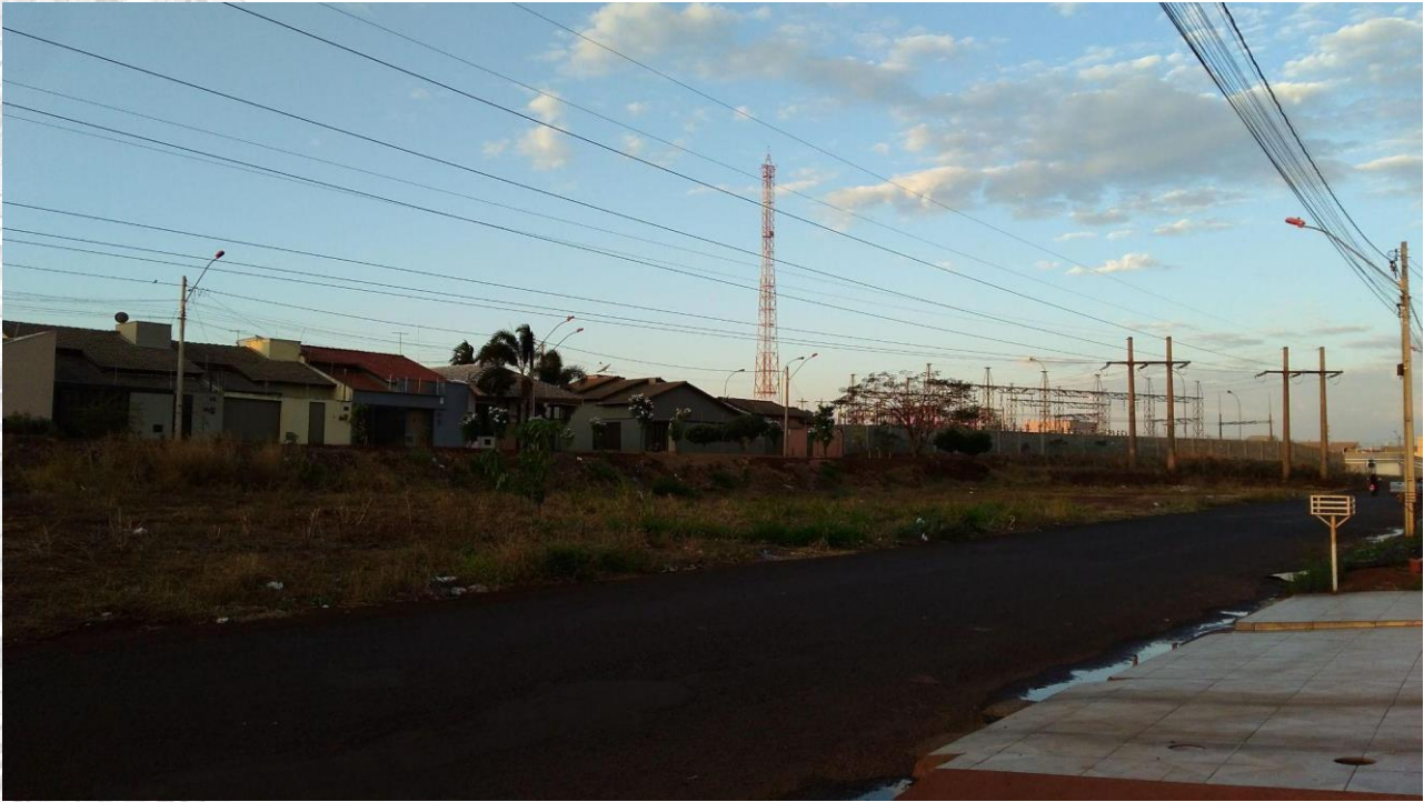
Figura 9 - Linhas de Transmissão e Subestação de Energia
