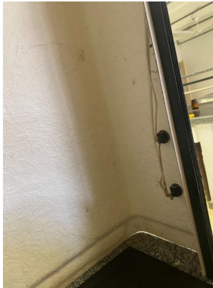
Figura 10 – Fios elétricos expostos.
