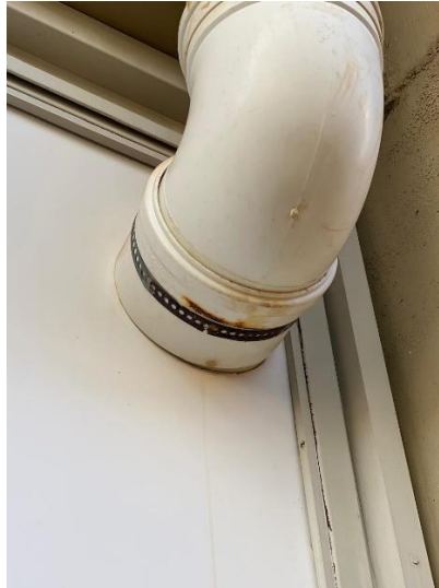
Figura 8 – Ferrugem apresentada no duto próximo ao arco de ferro devido ao vazamento de reagentes.
