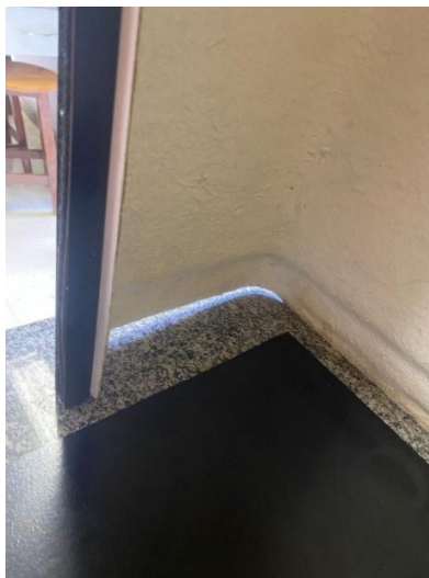
Figura 9 – Presença de aberturas na parte inferior da capela.
