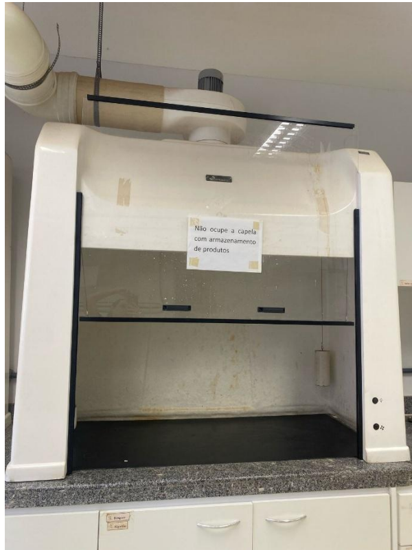
Figura 3 – Capela da marca Centauro já instalada nos laboratórios.
