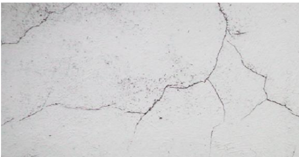
Figura 21 - Efeitos da dilatação térmica em concretos.
