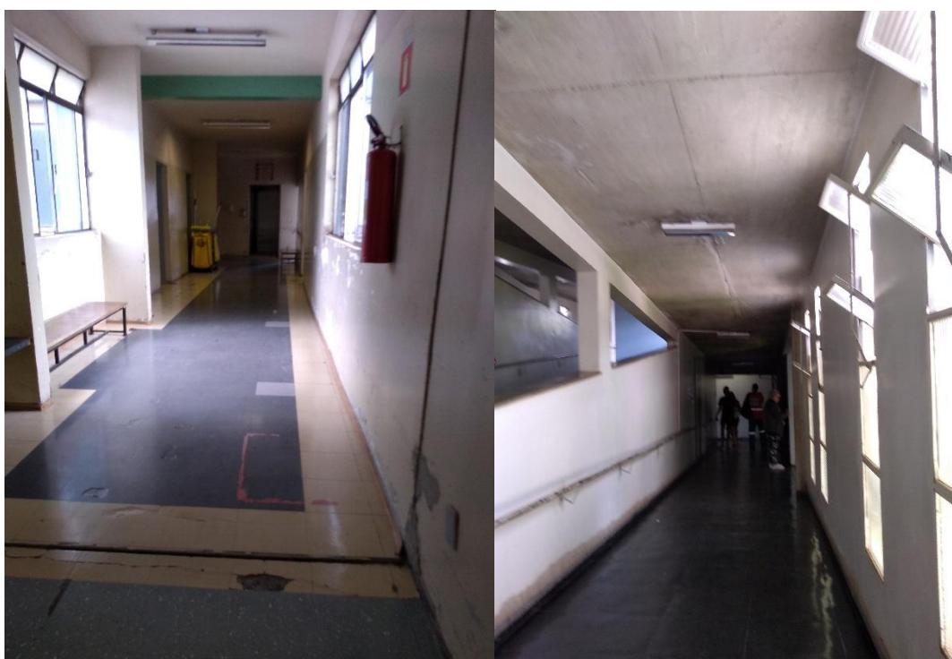
Figuras 3.1.1 – Detalhe da iluminação de corredores do HC-UFG
