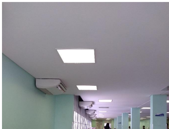
Figura 3.3.1 – Detalhe dos equipamentos de climatização da sala de espera do CEROF.
