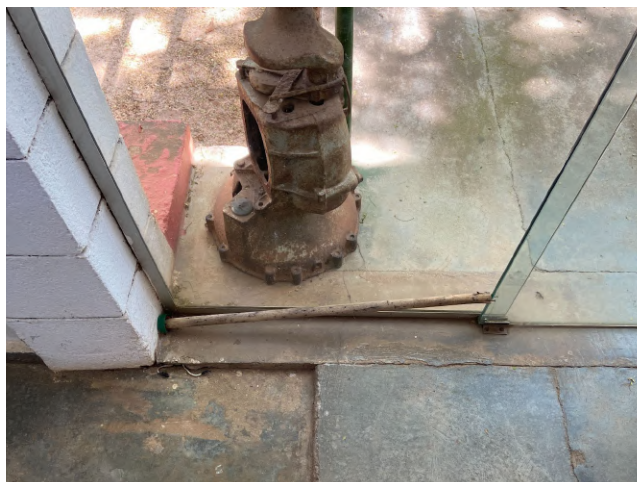
Figura 17 - Bloqueio de madeira nas portas do MAG Fonte: Henrique Moreira, 2022
