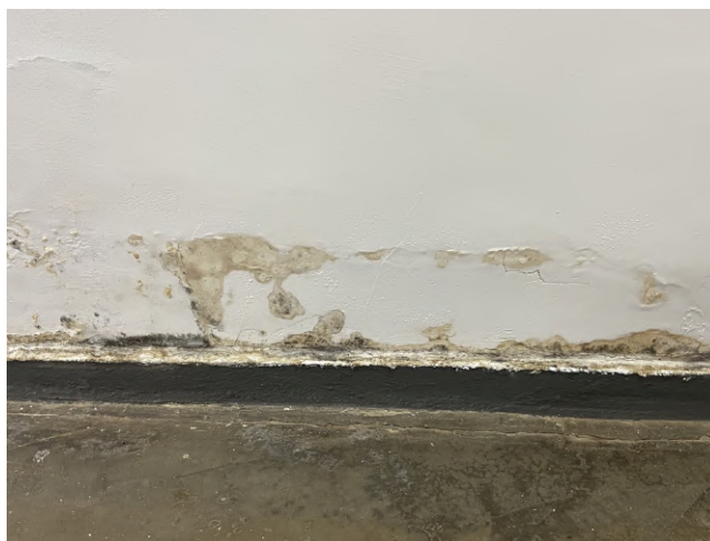
Figura 15 - Infiltração por capilaridade no MAG Fonte: Elaborado pelo autor, 2022
