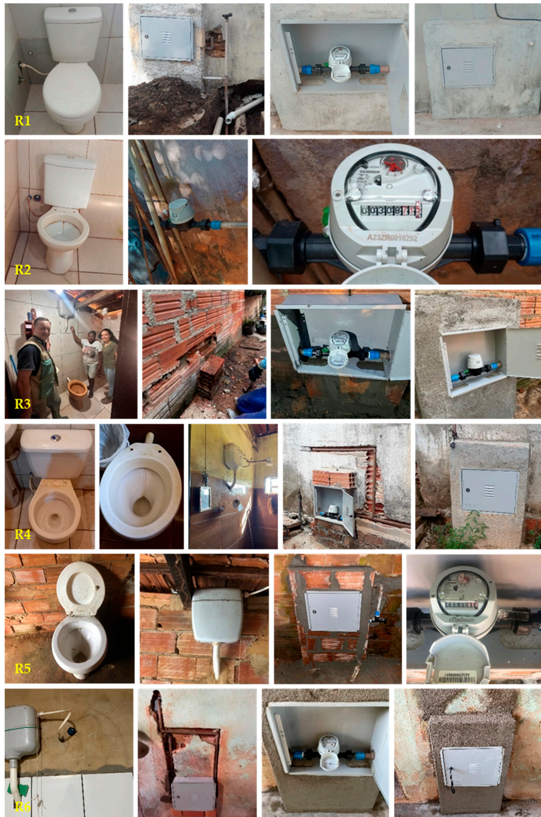
Figure 2. Bypass in the pipeline with the installation of a volumetric water meter before the toilet to record the volume of water used for flushing. Note: R1: Almeidas—Silvânia; R2: Queixo Dantas—Mimoso de Goiás; R3: Porto Leucádio—São Luíz do Norte; R4: Fazenda Santo Antônio da Laguna—Barro Alto; R5: José de Coletto—Colinas do Sul; R6: Rafael Machado—Niquelândia.
