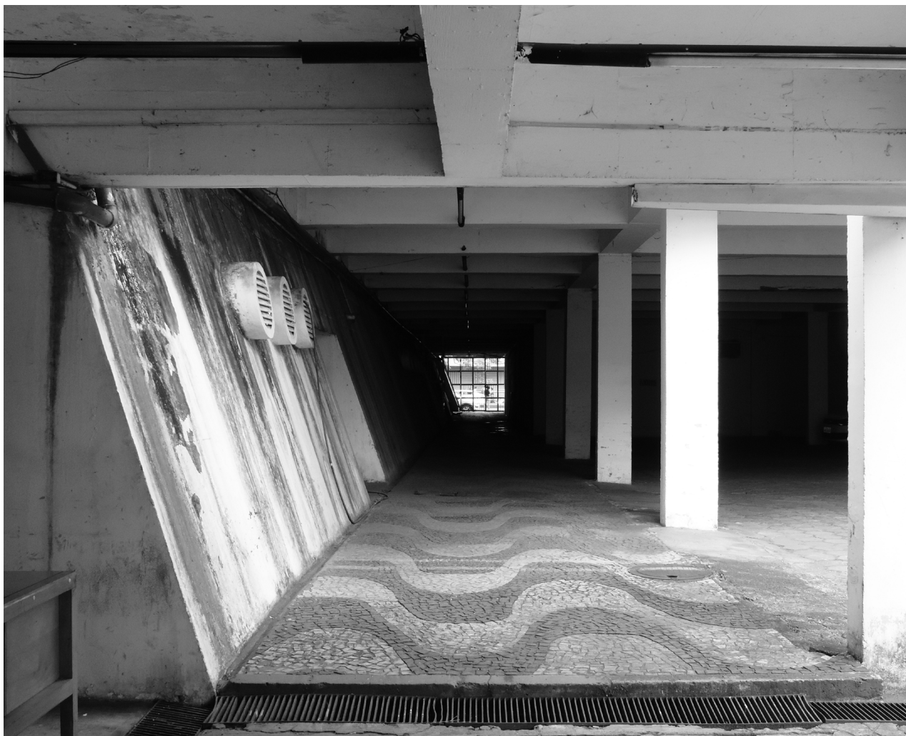
Figura 17. Planta baja, acceso peatonal paralelo a la calle interior, cubierta por la ampliación de la Plaza de las Piscinas, 2019. Fotógrafa: Jéssica Pinheiro de Vasconcelos. Fuente: Colección de la autora.
