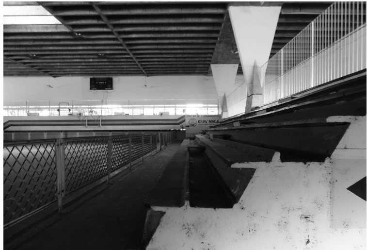
El edificio, entendido como un área cubierta y aterrizada, continúa con su estructura relativamente bien conservada.
