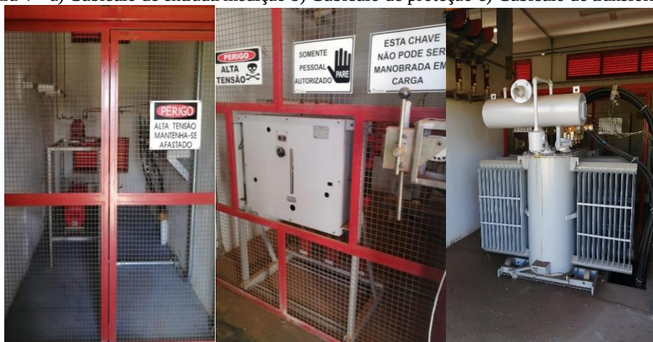
Figura 4 – a) Cubículo de entrada/medição b) Cubículo de proteção c) Cubículo de transformação
