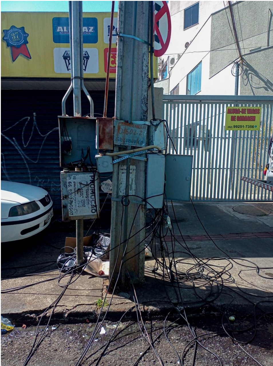
Figura 54 — Cabeamentos conectados em caixas de energia pública
