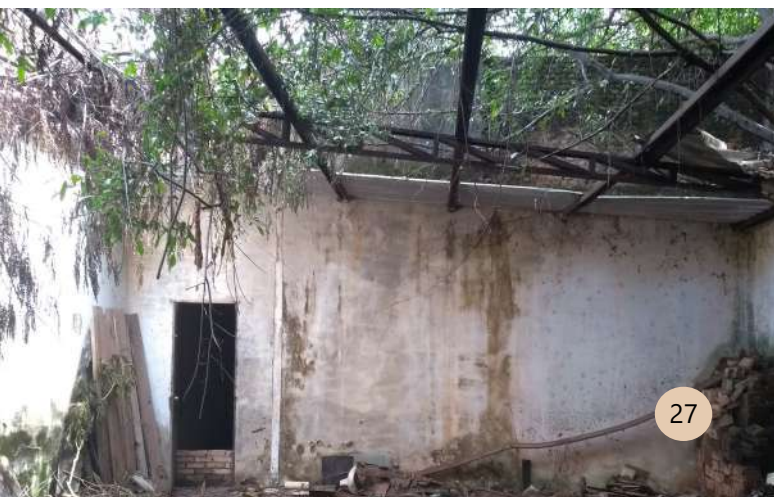
Figura 27. Vista Interna ao Edifício. Nota-se que neste ambiente o telhado cedeu, deixando as alvenarias expostas a agentes externos. Fonte: LAGO, Juliana. Data: Março /2019
