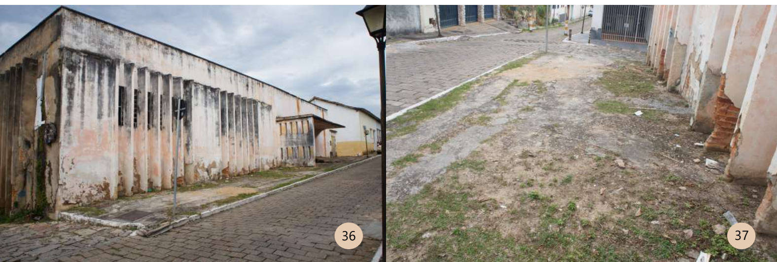
Figura 36 e 37. Frontal do Edifício. Nota-se que a calçada não possui rampas de acesso, o piso está em más condições, além disso o piso encontra-se quebrado com a presença de vegetação e material granulado (Areia, seixos, etc.). Fonte: LAGO, Juliana. Data: Maio/2019.
