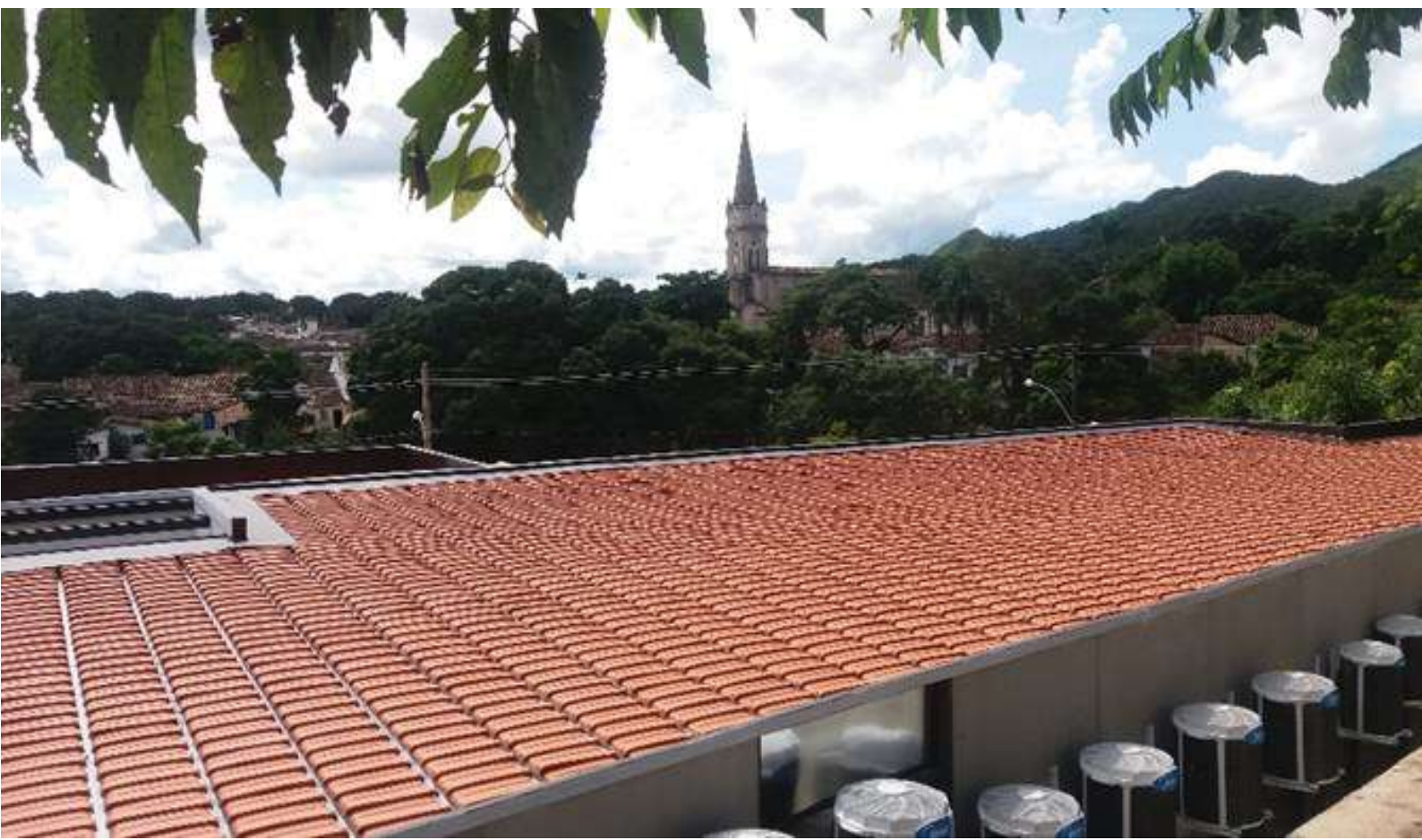
Figura 65. Prefeitura Municipal de Goiás. Cobertura do Bloco Anexo, telado cerâmico de baixa inclinação. Fonte: LAGO, Juliana. Fevereiro/2018.
