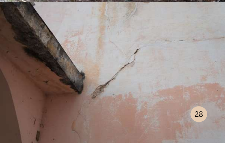
Figura 28. Vista Externa ao Edifício. Nota-se a rachadura existente na fachada principal do edifício causada pelo sobrepeso da marquise. Fonte: LAGO, Juliana. Data: Março /2019
