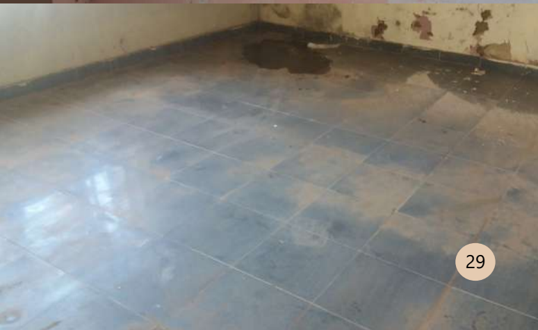
Figura 29. Vista Interna ao Edifício. Piso em granito presente no salão, verifica-se que o mesmo encontra-se em bom estado de conservação. Fonte: LAGO, Juliana. Data: Março /2019
