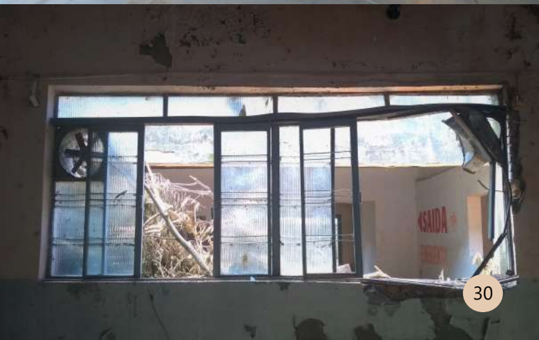
Figura 30. Vista Interna ao Edifício. Imagem de esquadria danificada. Fonte: LAGO, Juliana. Data: Março /2019
