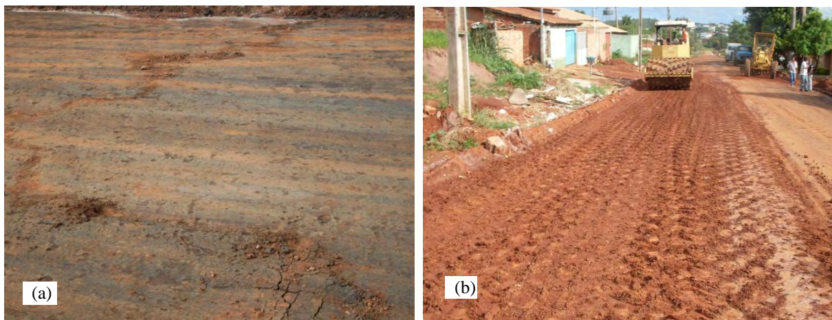
Figura 4.15 – Problemas observados no subtrecho de solo-fosfogesso-cal: (a) Expansão da camada ; (b) Restauração do bordo esquerdo depois da expansão.
