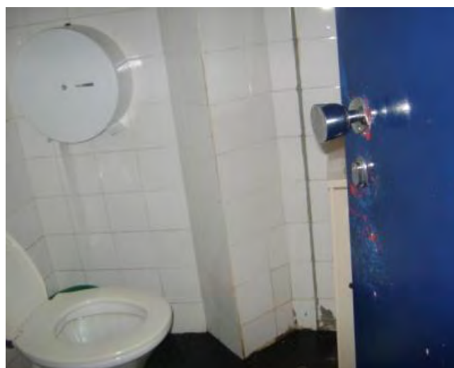
Figura 4.42 – Junta de dilatação inadequada, em área molhada
