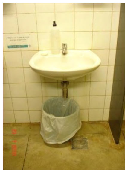
Figura 4.51 – Baldes sob lavatórios para recolher água para limpeza por meio da retirada do sifão
