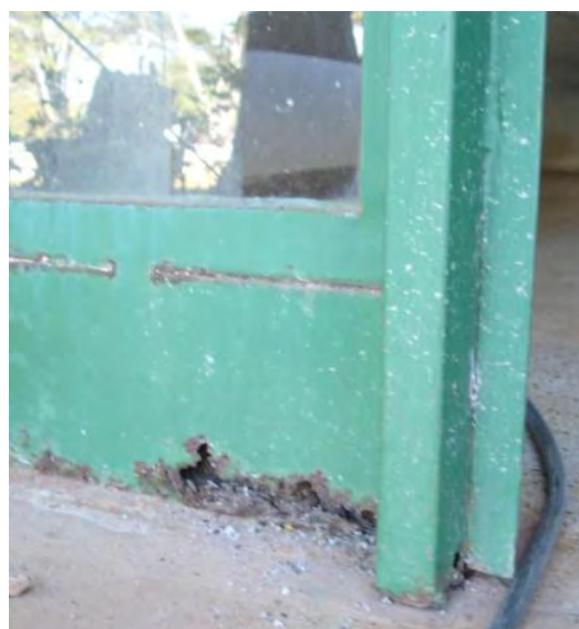
Figura 4.31– Parte inferior da porta corroída
