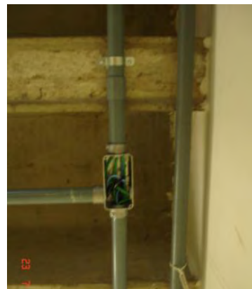
Figura 4.37– Instalações de rede estruturada aparentes
