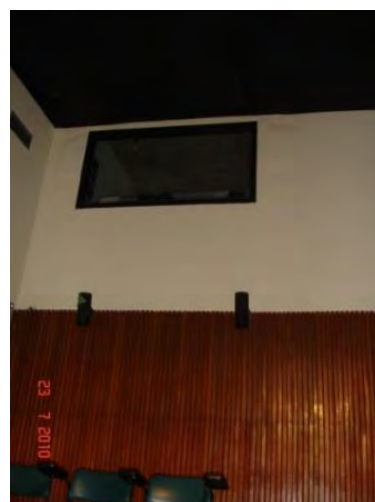
Figura 4.46 - Revestimentos acústicos realizados pontualmente, o teatro é um exemplo desta intervenção
