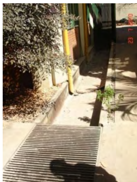
Figura 4.33 – Grelhas para captação de águas pluviais
