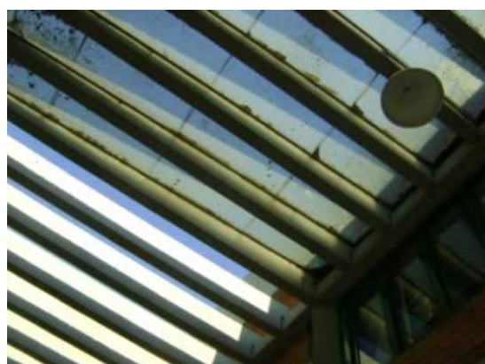
Figura 4.39- Cobertura em vidro aramado, difícil limpeza e manutenção
