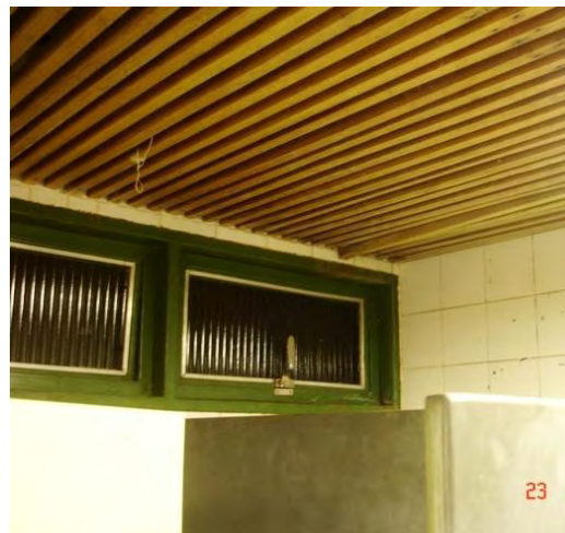
Figura 4.87 - Forros de ripas de madeira conferem aparência negativa aos sanitários
