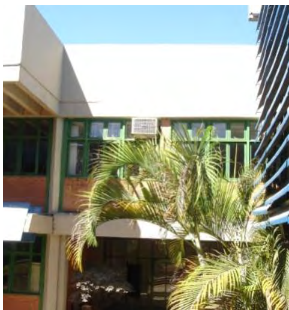
Figura 4.24 – Dificuldade de manutenção do condicionador de ar
