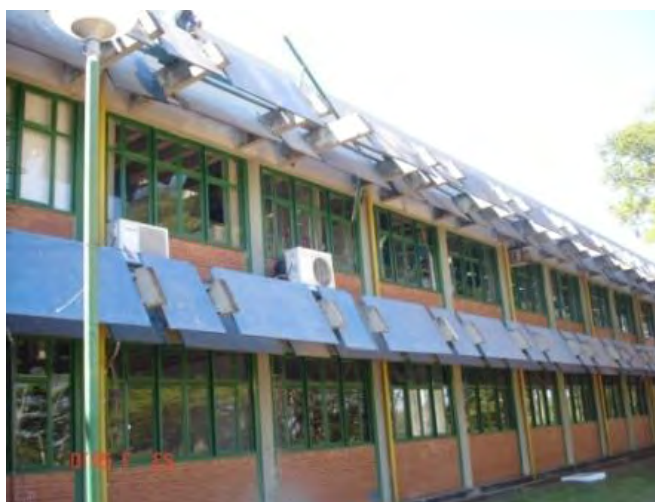
Figura 4.45 - Tijolo a vista, uso de seladora periodicamente
