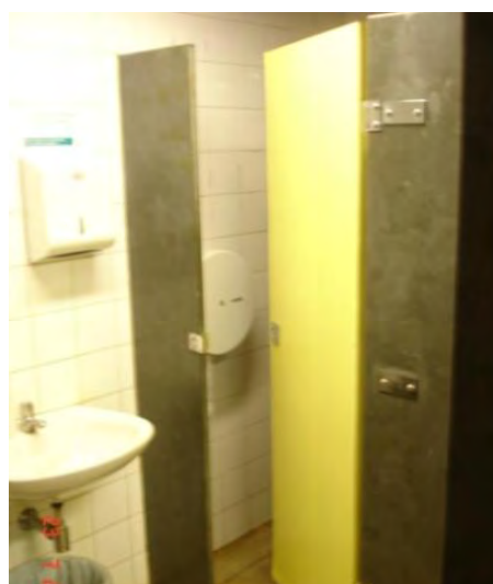
Figura 4.53 - Portas de laminado melamínico devem ser substituídas pelas de alumínio
