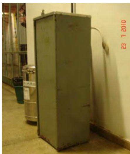
Figura 4.26– Bebedouro com a parte inferior enferrujada
