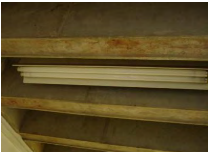
Figura 4.35– Lâmpada embutida entre as nervuras da laje
