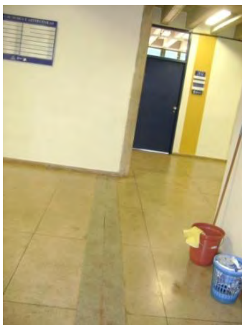
Figura 4.47 – Remendos para adequações físicas em piso de granitina
