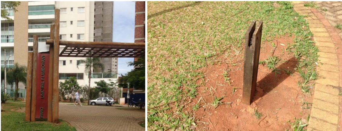
Figuras 55 e 56: Equipamentos urbanos deteriorados - Parque Flamboyant, 2017. Fonte: Acervo do autor (2017).
