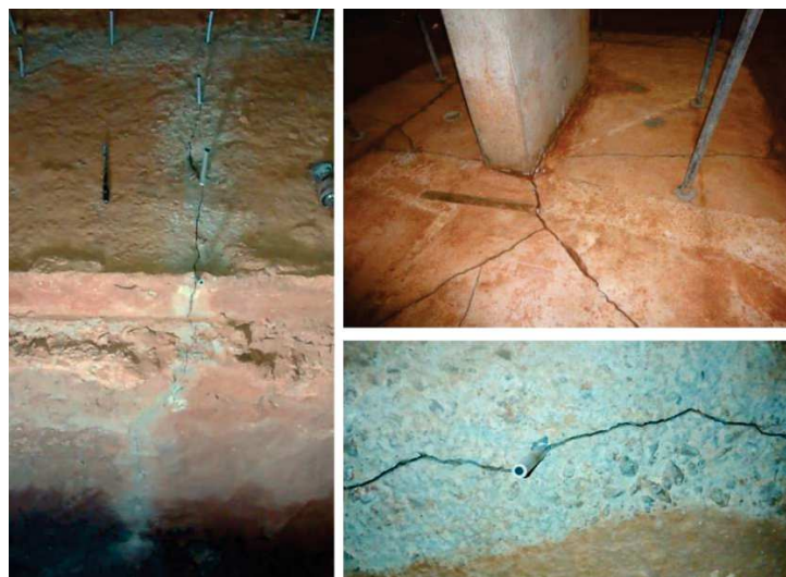
Figura 2.21 – Fissuras observadas em bloco de fundação decorrentes do calor de hidratação (CASCUDO, 2014).
