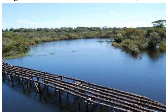
Figura 09 - Ponte desativada sobre o Rio Tigrinho na Cidade de Britânia/GO, 2022
