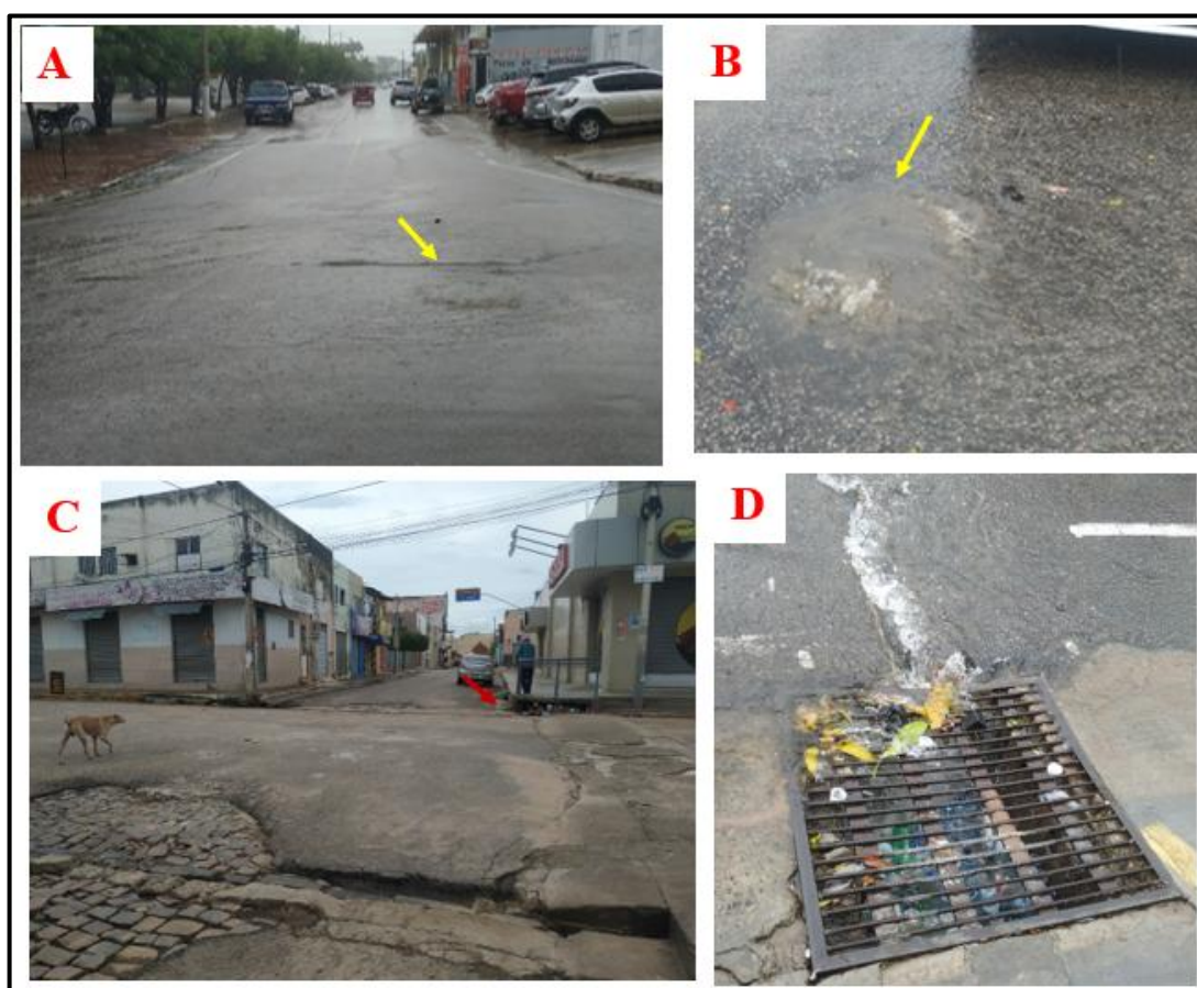
Figura 37: Parte das estruturas de drenagem urbana.
