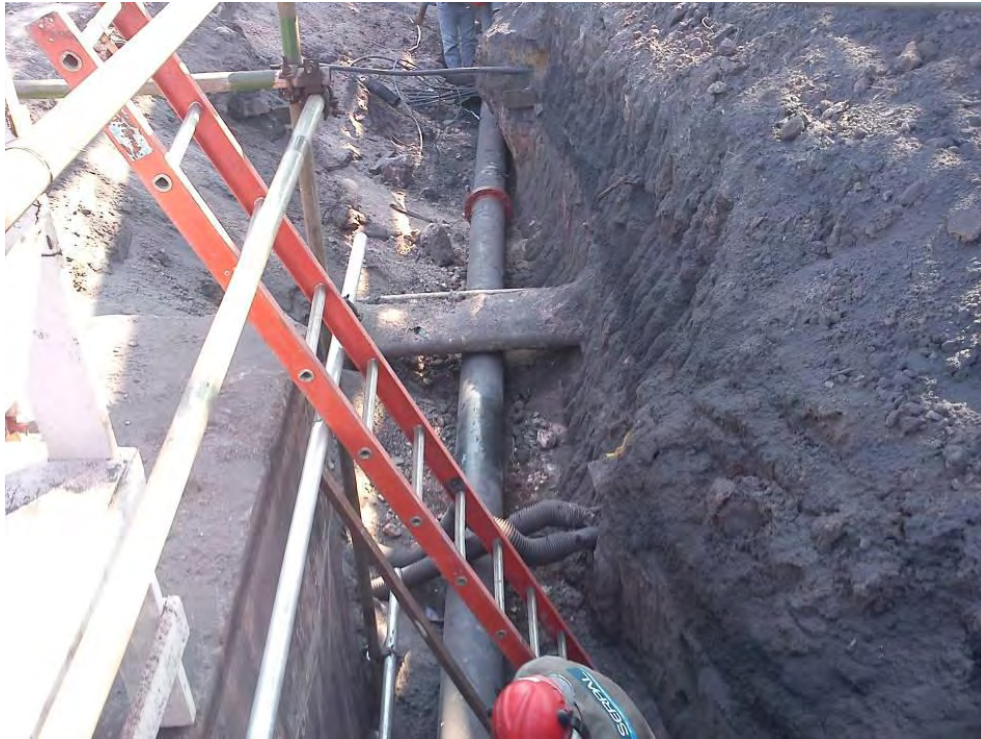
Figura 4.8 - Interferência encontrada após escaneamento do terreno
