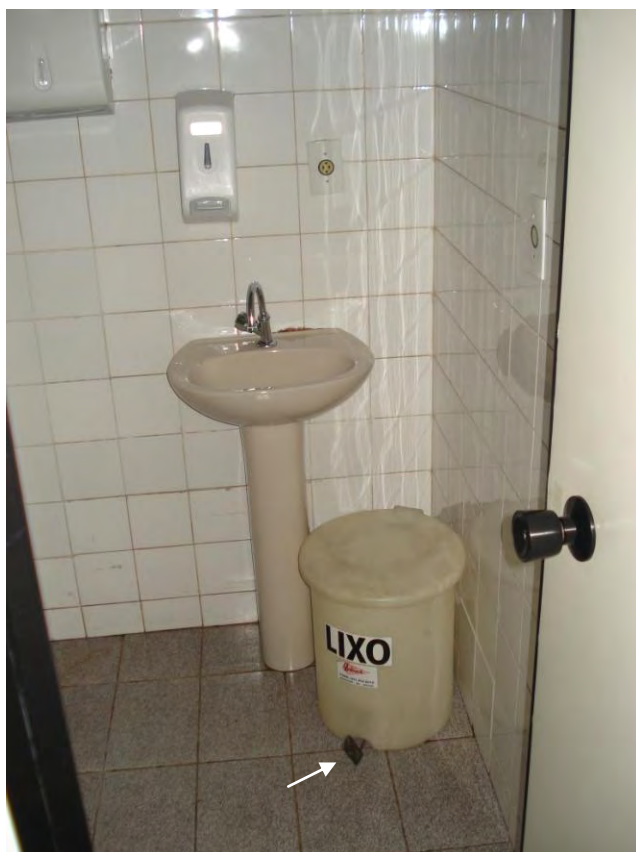
Foto 9 – Lixeira com acionamento de pedal danificado (H2)
