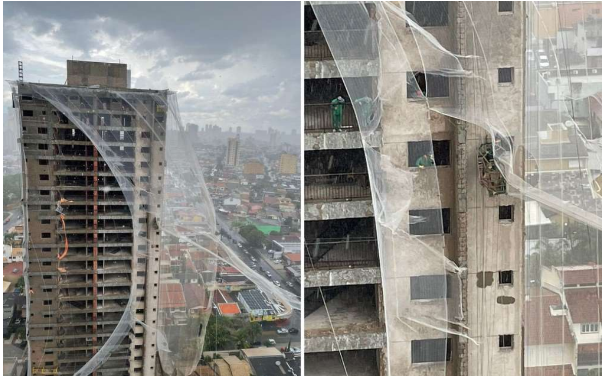
Figura 39 — Trabalhadores ficam pendurados após cabo de aço arrebentar durante temporal, Goiânia – GO
