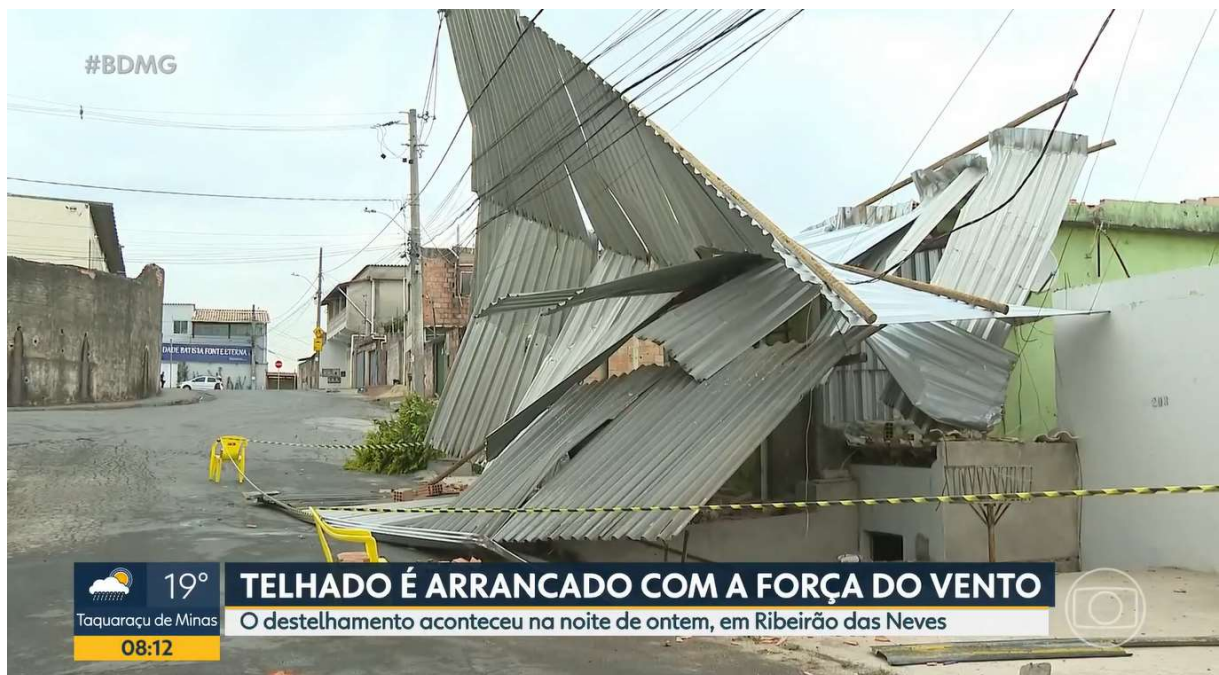
Figura 40 — Destelhamento durante tempestade em Ribeirão das Neves – MG
