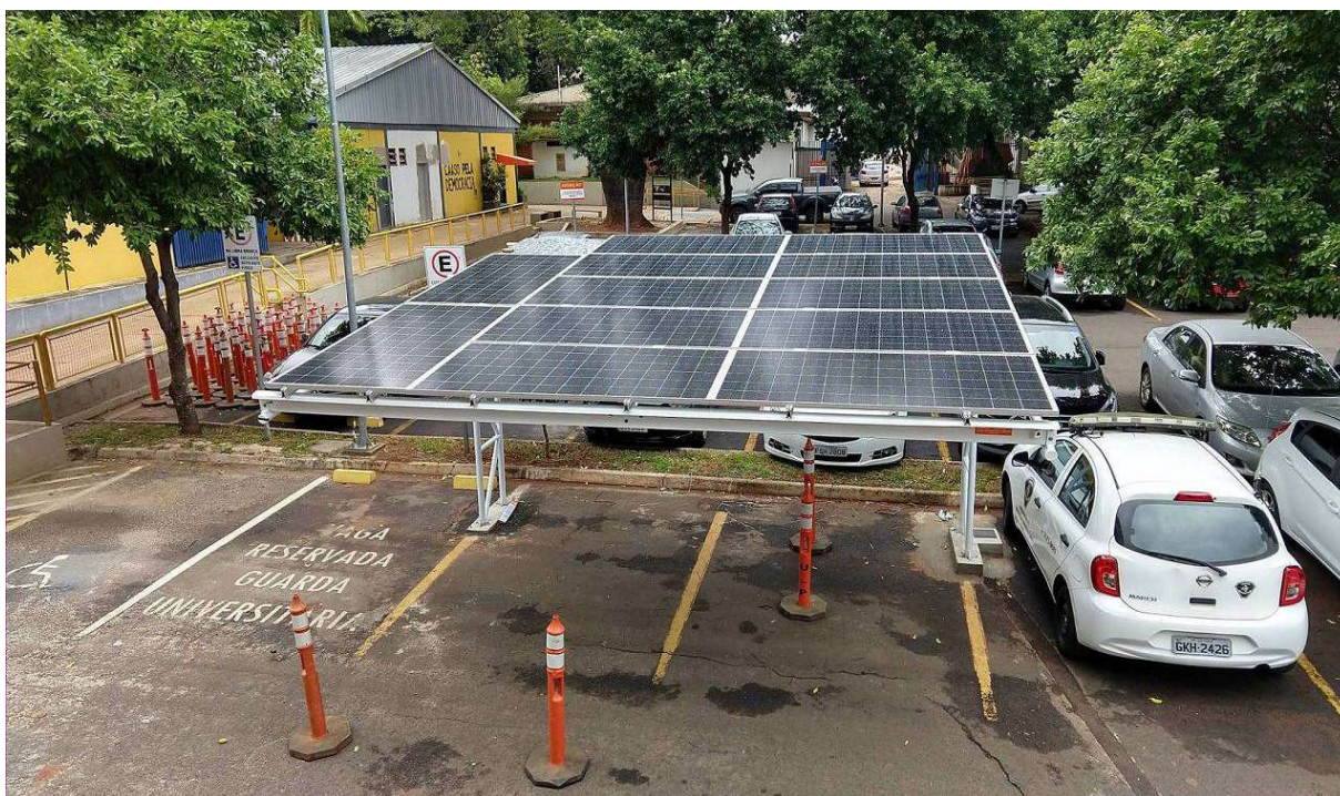
Figura 37 — Cobertura RTD Engenharia e WEG Solar (SEL/EESC/USP)
