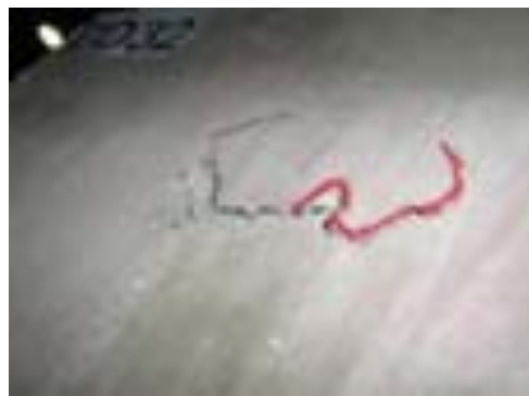
(b) Fissuração localizada no conector
