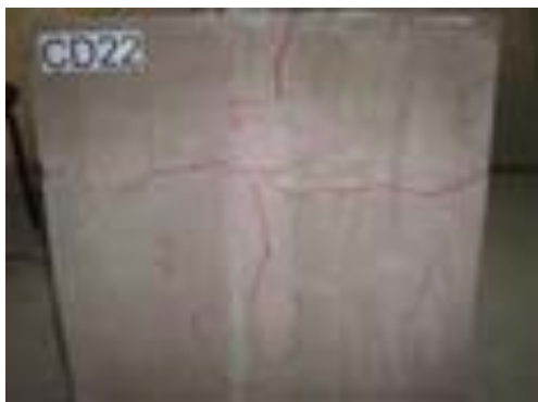
(a) Fissuração horizontal e vertical
