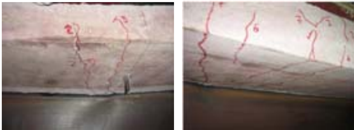
Figura 4.14 – Modos de rupturas das vigas V1A e V1B
