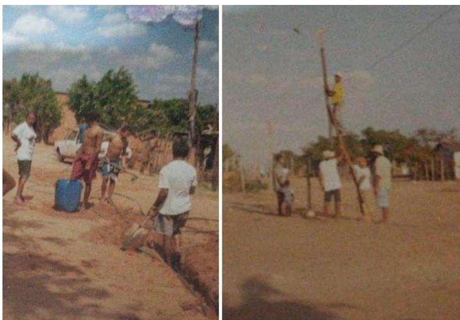
Figura 8 - Moradores do setor Alto Bonito trabalhando nas redes clandestinas de energia e água
