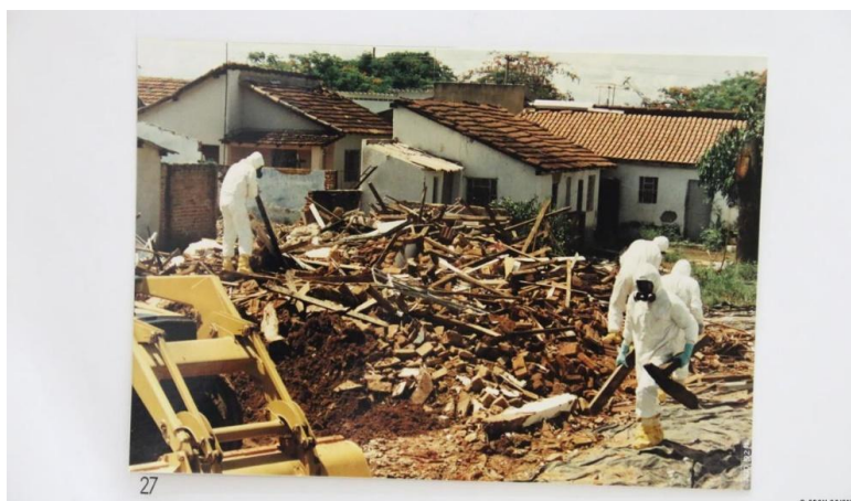
Figura 11 - Casas demolidas no local e vizinhança do foco da contaminação
