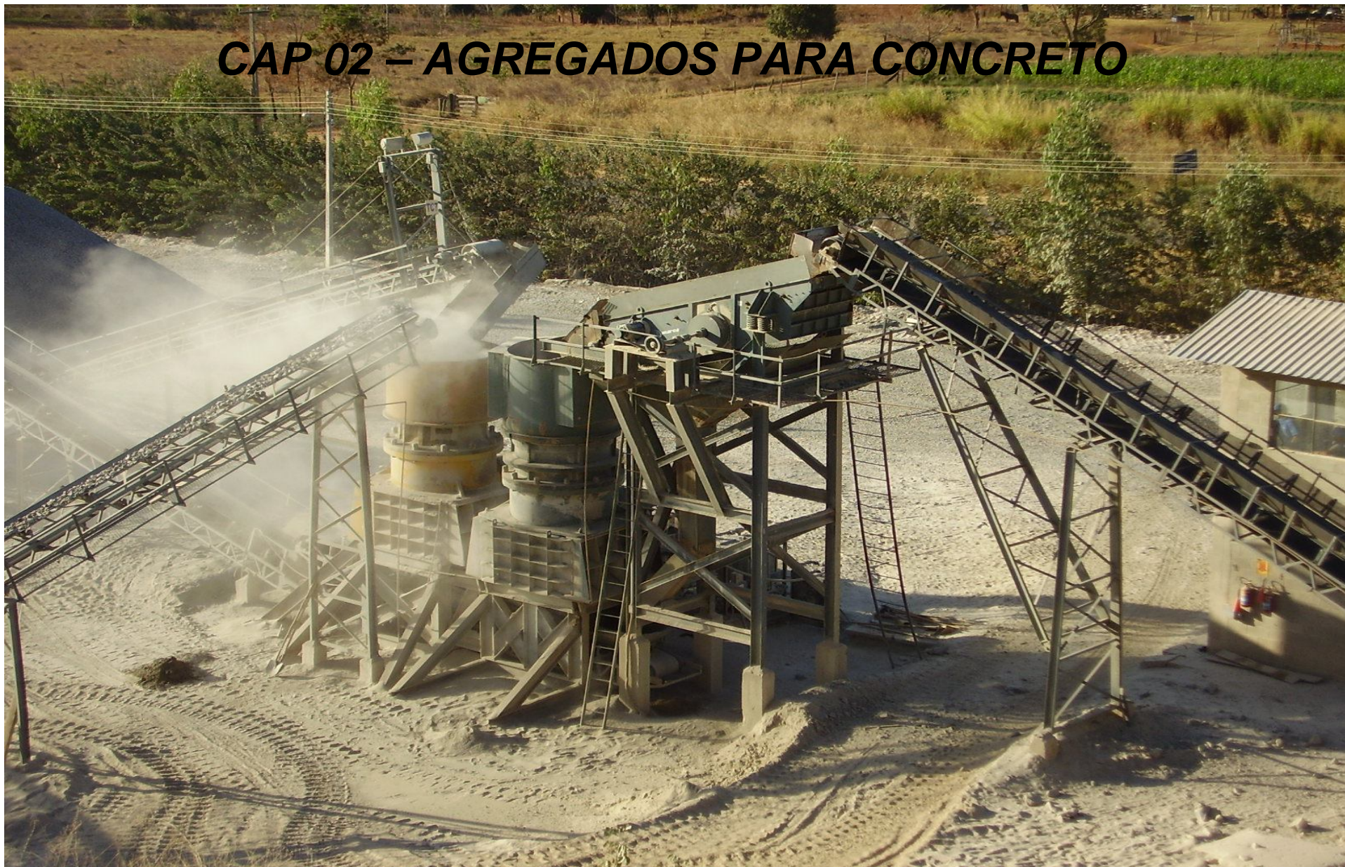
Figura 2.13 – Britadores da planta de britagem da Britagran
